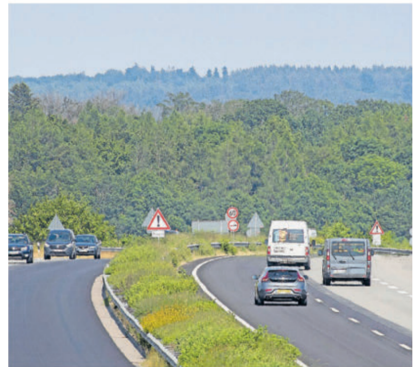
Im Zuge der A60 in Fahrtrichtung Wittlich zwischen den Anschlussstellen Badem und Spangdahlem sowie in Fahrtrichtung Bitburg kommt es zu Verkehrsbeschränkungen. Die dunklen Beläge zeigen, wo die Straße schon fertig ist. FOTO: RUDOLF HÖSER
